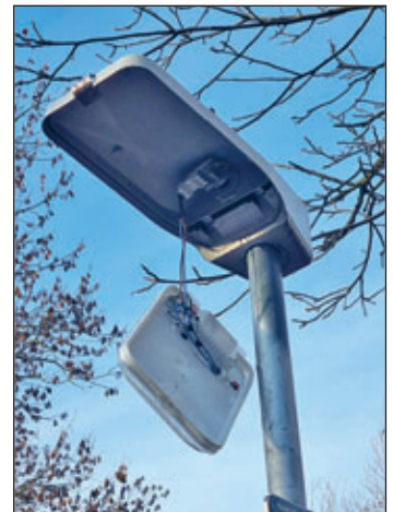
An der Unterführung Bahnhofsborg zur Kita wurde das Leuchtmittel herausgeschlagen. Diese Laterne war gerade mal 3 Monate in Betrieb.
