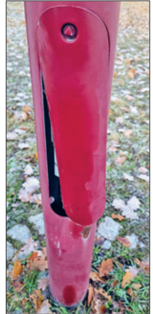
Im Bauernring in Stauchitz wurde der Lichtmast, wahrscheinlich durch Unachtsamkeit Dritter, stark in Mitleidenschaft gezogen.
